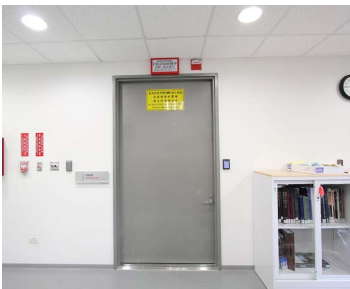
圖片說明：國立清華大學新總圖書館的特藏室配備FM200氣體性自動滅火設備。
